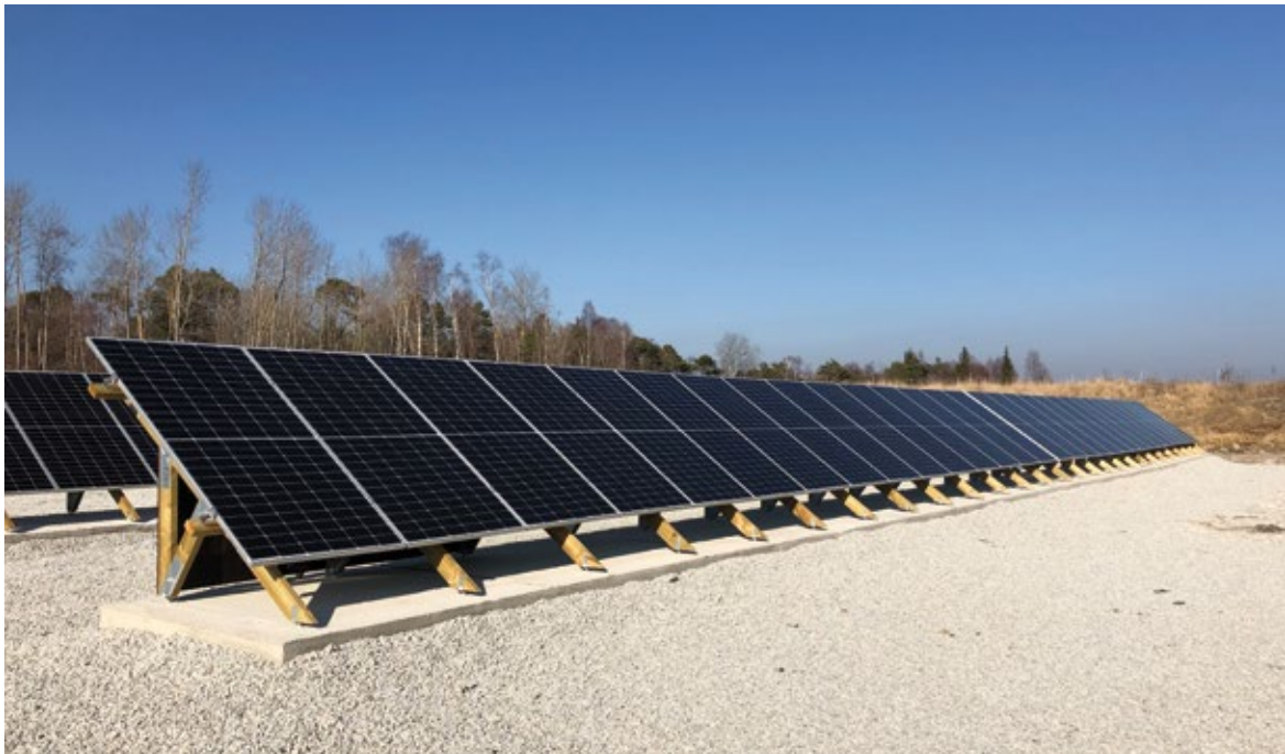
Solcellerna vid reningsverket.
