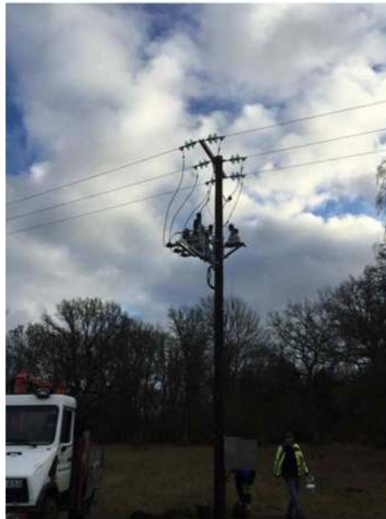
Figur 3: Installation av en, av sju, zonbrytare som ingick i projektet.
